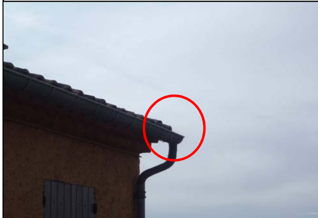
Photographie du défaut
